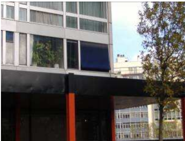
Détail de façade (aile sur dalle Modigliani) Store extérieur détérioré (V2 1894)
