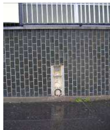
Détail de la façade sur rue Mouchotte Coffret EDF détérioré (V4 2434)
