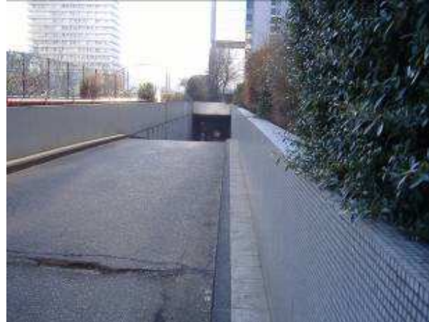
Dalle-terrasse Modigliani (V9P1 3648) Accès voitures à la terrasse Modigliani Enrobé et étanchéité en mauvais état
