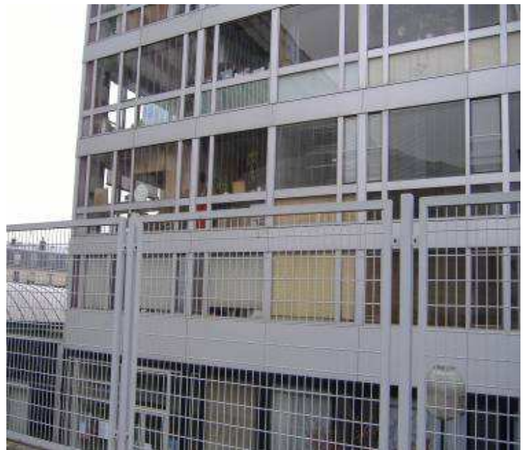
Détail de la façade Nord-Est (V1 1644) A l'angle de l'avenue du Maine
