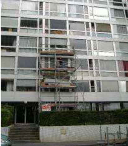
Bandeau horizontal au 2ème étage escalier C (V19 6464) vue générale du mode de fixation des façades type murs-rideaux.
